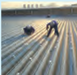
宝钢股份金太阳光伏发电示范工程
