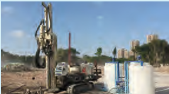
直压注入系统
